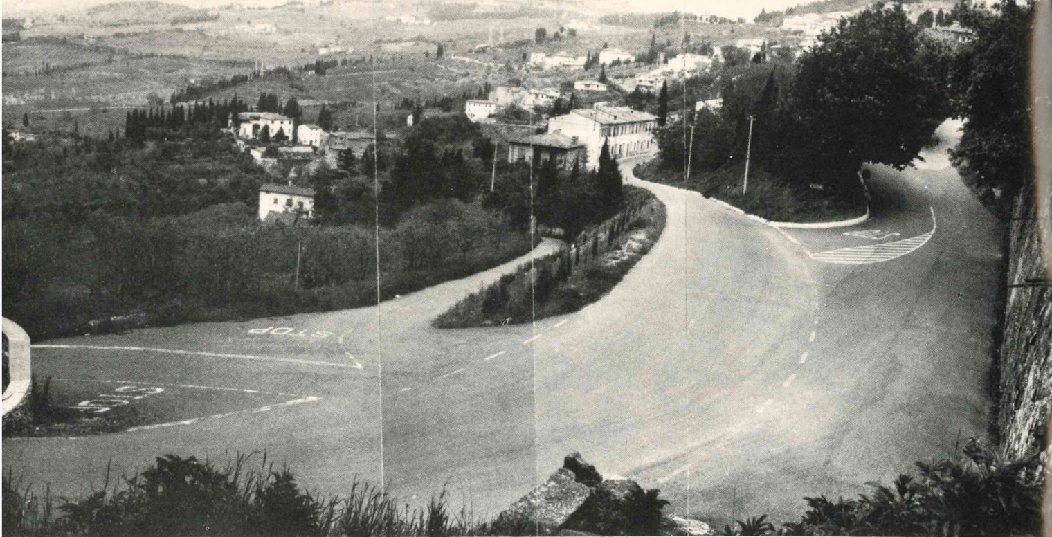
Svincolo di S. Anna - Strada di collegamento Fiesole-Valle del Mugnone dopo i lavori.
