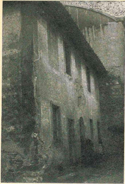
PIGNINO: abitazione pericolante.
